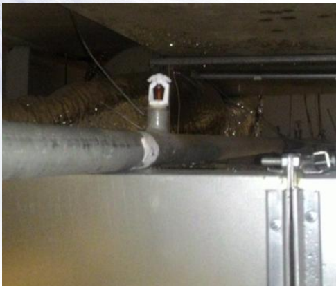
Ороситель, смонтированный в трубе над воздуховодом
