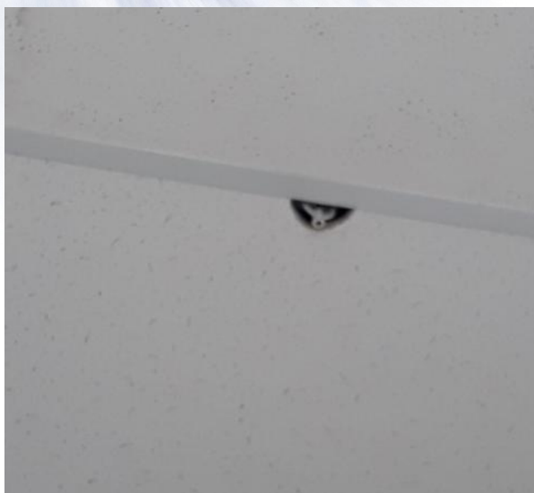
Неправильный монтаж оросителя в потолке типа «Армстронг»
