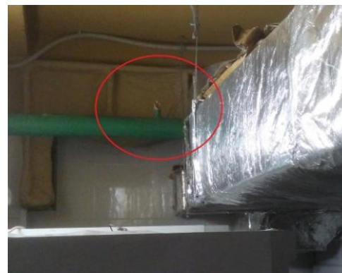
Ороситель смонтированный в помещении с холодильным оборудованием, вблизи с нагревательным элементом (компрессором)
